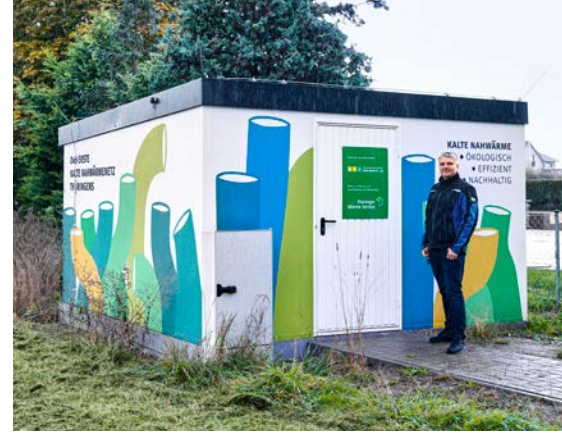
Die Pumpstation ist das einzige, was darauf hindeutet, dass unter der Erde eine riesige Heizung für die ganze Nachbarschaft liegt.
