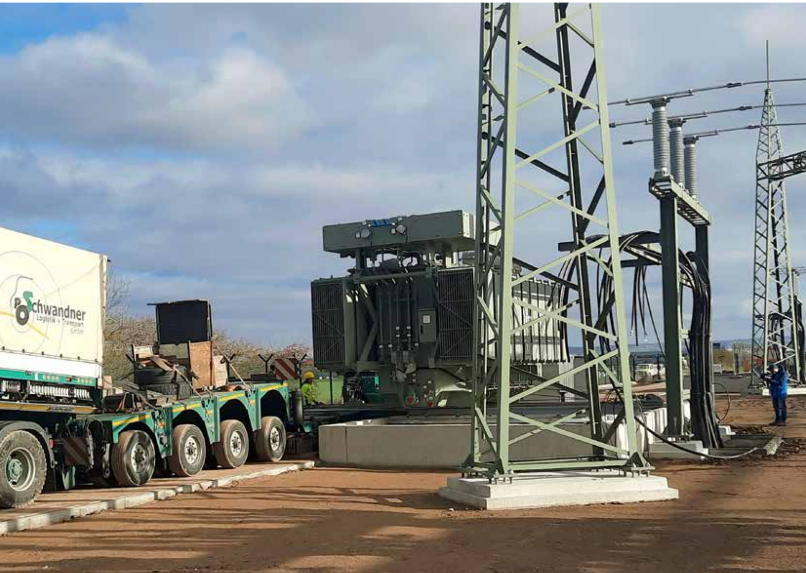
Das neue TEN-Umspannwerk Wachsenburg wird die Batteriefabrik CATL im Industriegebiet Erfurter Kreuz sicher mit Strom versorgen. Jeder der zwei Transformatoren für das neue Umspannwerk wiegt circa 87 Tonnen.
